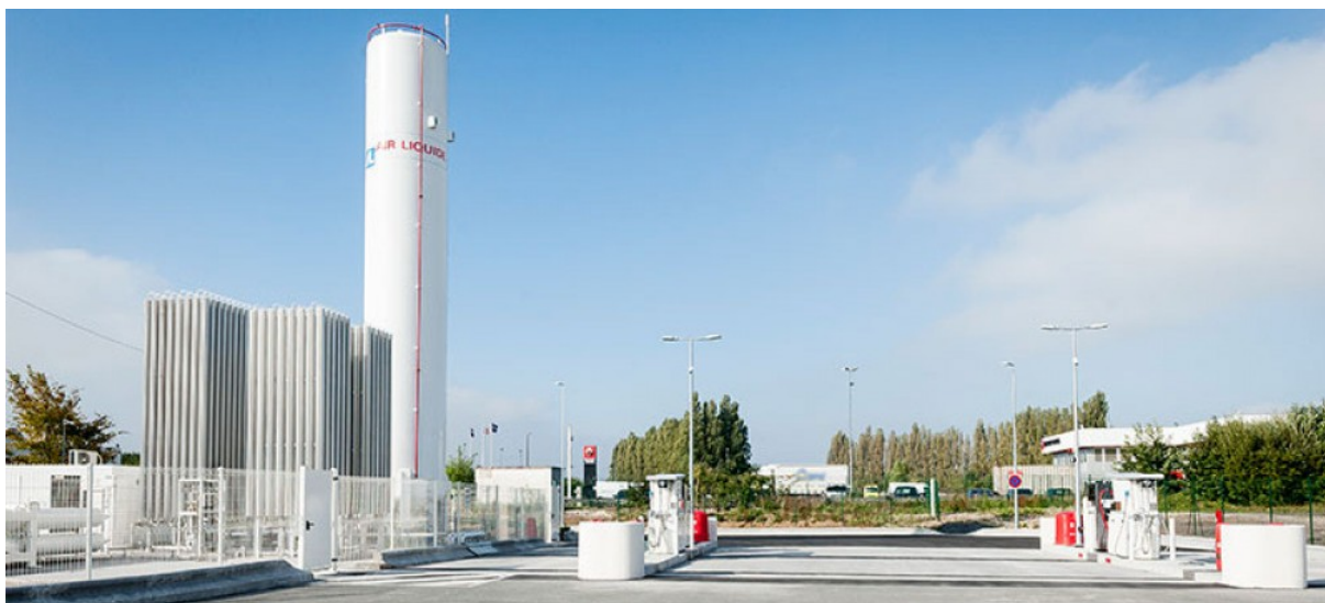
Installation de remplissage en GNL © Air Liquide
