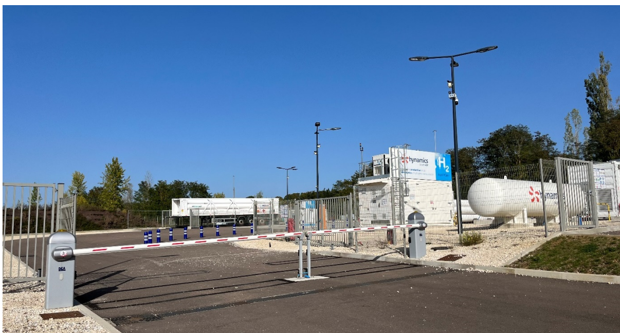
Station de recharge de bus à l'hydrogène – Auxerre (89) © Djamel Ferrand – DGSCGC
