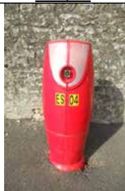
PI avec un marquage rétro -réfléchissant
