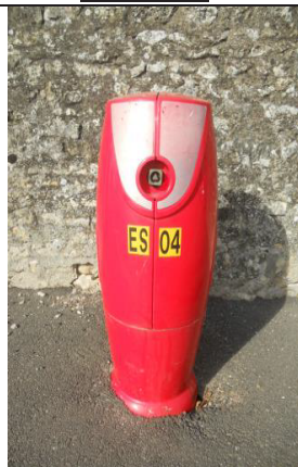
PI avec un marquage rétro -réfléchissant
