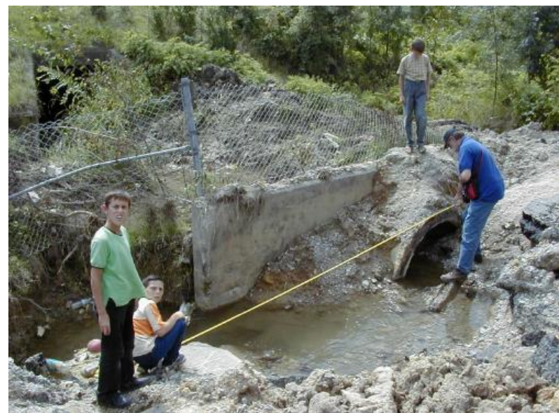
Décrochement de près de 4 Mètres d'un collecteur, IZMIT, 1999, doc.AFPS
