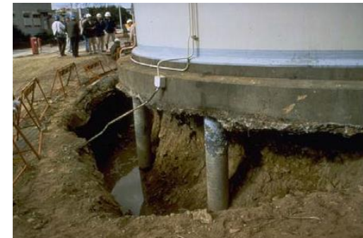
Tassement du sol provoqué par la liquéfaction du sol , Kobé 1995 (mais fondations conçues PS !)
