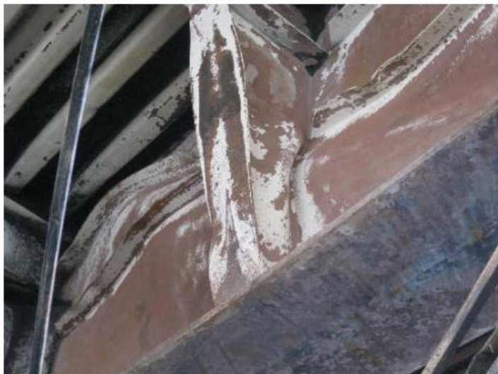
Flambement de l'âme de la poutre aval (Haute de 4 m)
