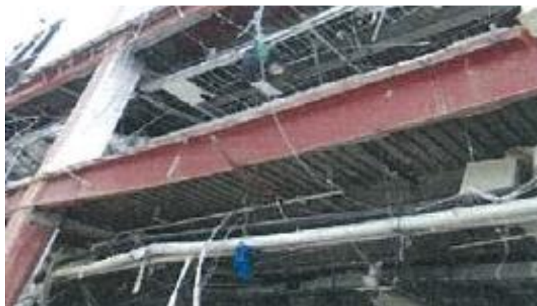
Déversement d'une poutre de grande portée (Sendai – Séisme de Tohoku 2011, Japon – Source Rapport Université de Hokkaido)
