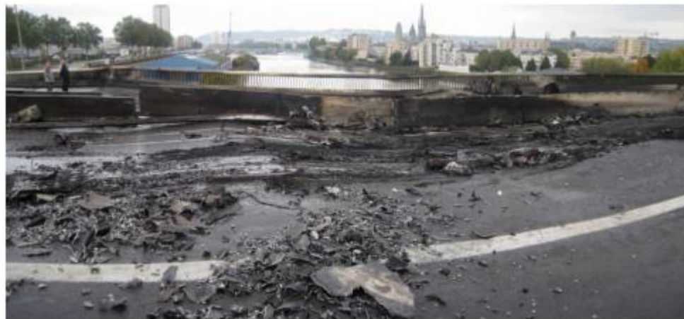
Ondulation du platelage de la chaussée
