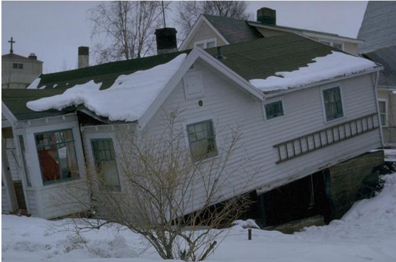
Défauts d'ancrages (Alaska)
