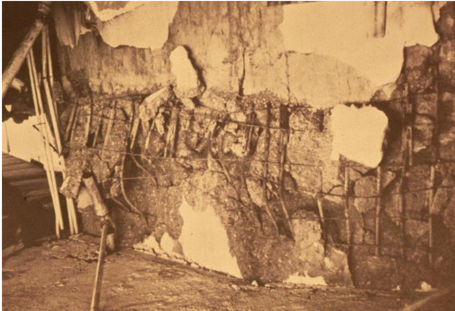
Eclatement en pied d'un voile pas suffisamment ductile Spitak, Arménie 1988
