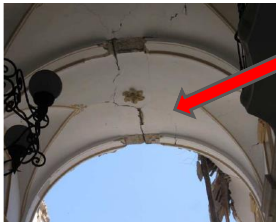
Séisme de Lorca, 2011, doc AFPS Fissure longitudinale de la voute de la nef
