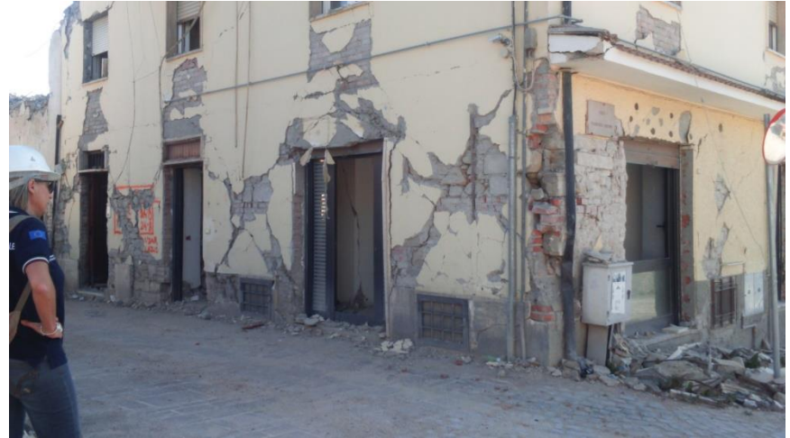
Fissuration en croix des trumeaux au RDC Italie, 2016
