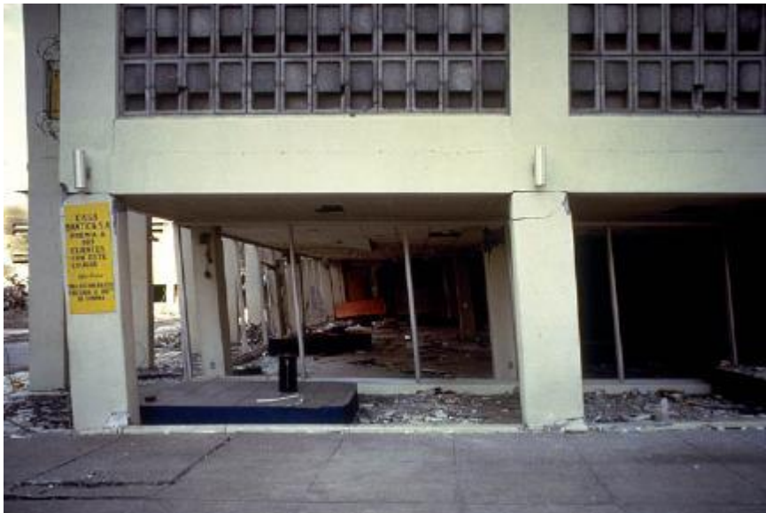
Doc.NISE USA, Arrachement des têtes de poteaux sous la poussée horizontale
