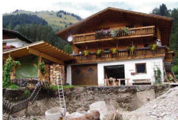
Affouillements verticaux supérieurs à 1 m
