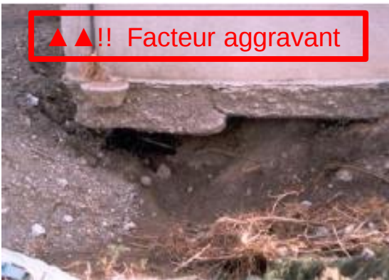
Affouillement des fondations induisant un tassement différentiel (Doc. CSTB)
