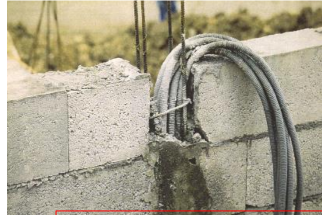
Gaines électriques dans chainage 1998, doc P. Balandier
