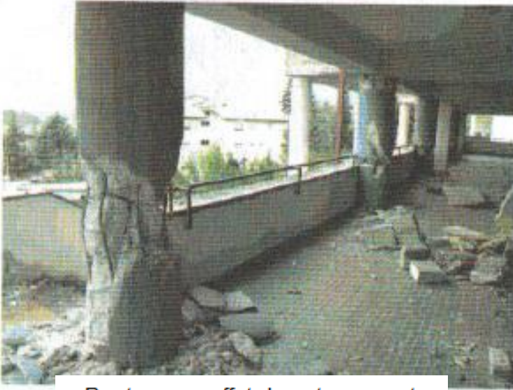
Rupture par effet de poteau court [L'AQUILA, 2009]
