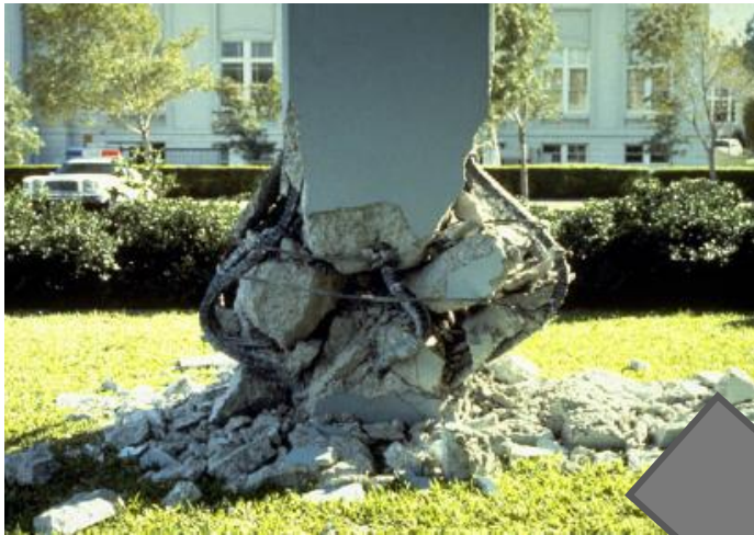
Insuffisance de confinement en pied de poteau: les armatures ont flambées de par l'absence ou l'insuffisance de cadres. Californie, 1979, doc. NISEE, USA
