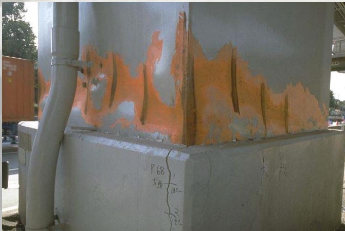
Cloquage d'un pied de poteau acier tubulaire (Séisme de Kobé, 1995) (Document EQIIS – USA)
