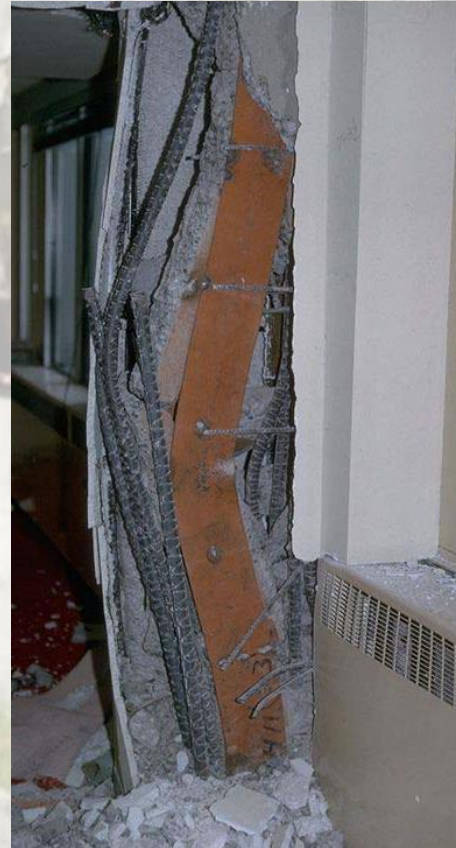
Flambement d'un poteau d'acier enrobé de BA (Séisme d'Anchorage, 1964) (Document Karl – V. Steinbrugge)
