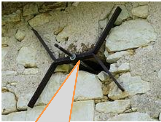
Ancre en X apparente reliée au tirant traversant les maçonneries
