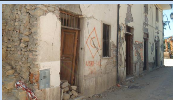
Fissuration d'origine mécanique, séisme, sur murs de maçonnerie (Amatrice-2016)
