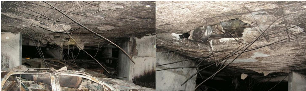
Feu dans le parc de stationnement couvert de la résidence Le Chesnay dans les Yvelines, le 22 novembre 2010 : 50 véhicules brûlés.
