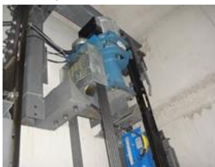
Système à câble
