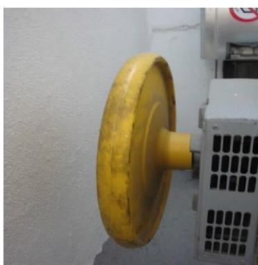
Volant de manœuvre à poste.
