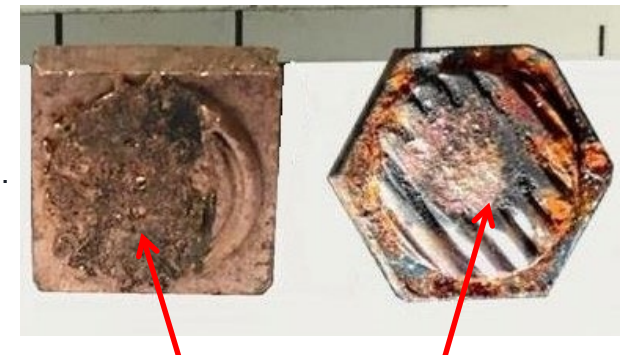
Traces d'arc électrique sur borniers (fusion)
