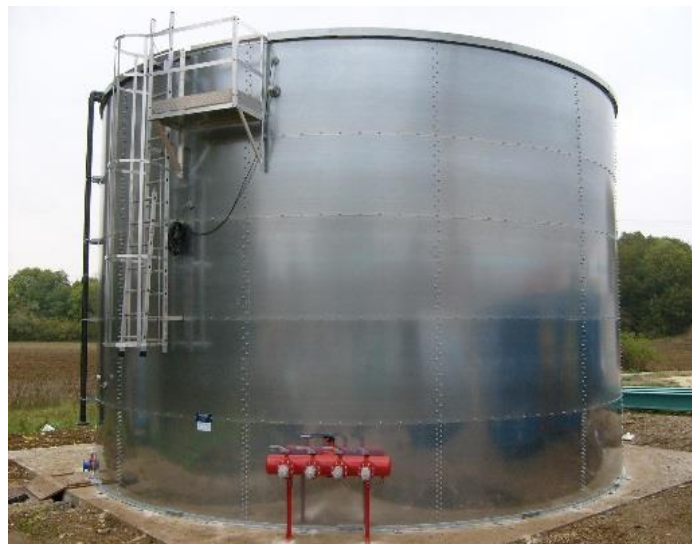
Illustration n°10: réservoir aérien avec dispositif d'aspiration déporté
