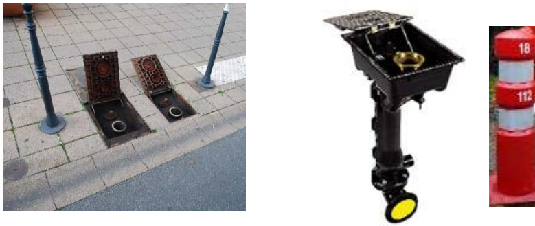
Illustration n°11 : Exemple de bouche d'incendie
